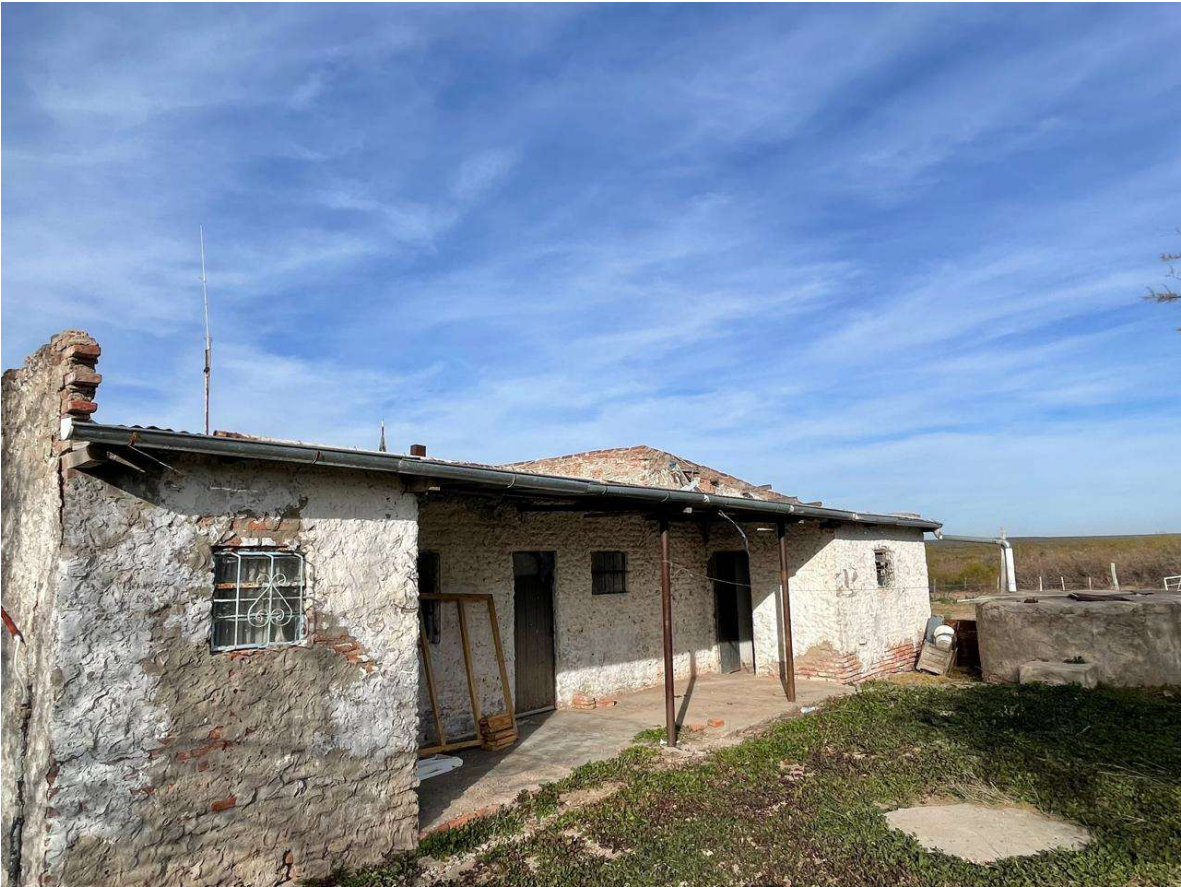
Imagen 1. Estado de la casa del establecimiento.
